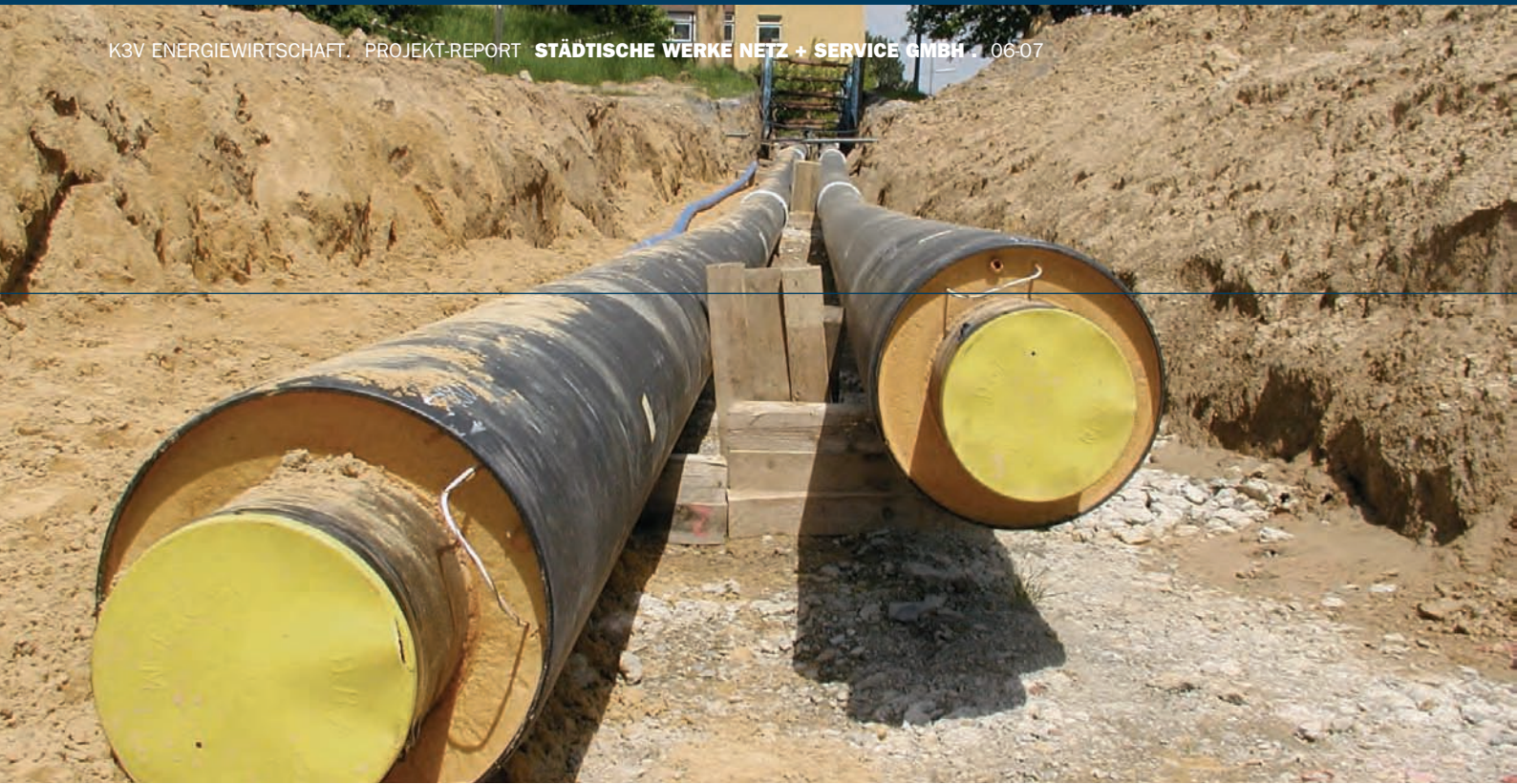
▲ Fernwärme Helleböhn Foto: Kasseler Verkehrs- und Versorgungs GmbH
